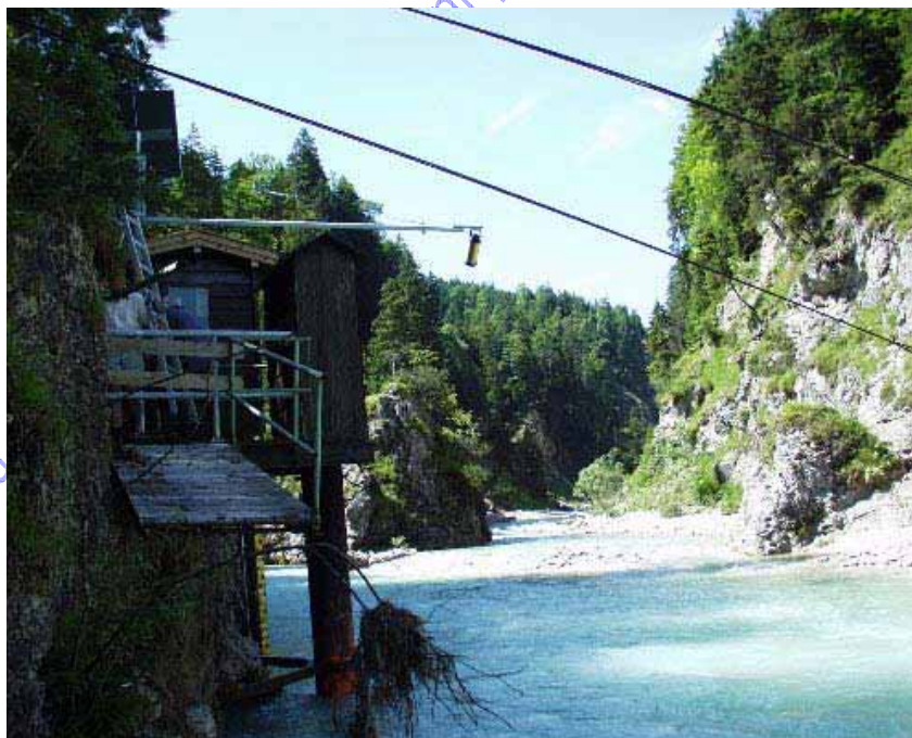
Figure 15 – SIMK® - station de débit au fil de l'eau Rissbachdüker / Rissbach (commande WWA Weilheim)
